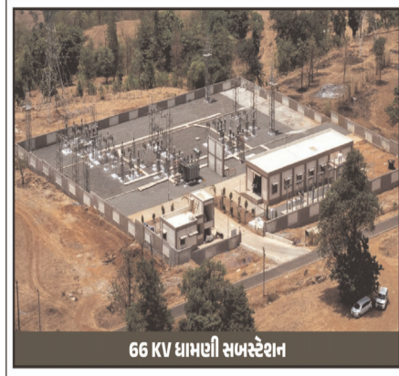
66 KV શામણી સબસ્ટેશન
